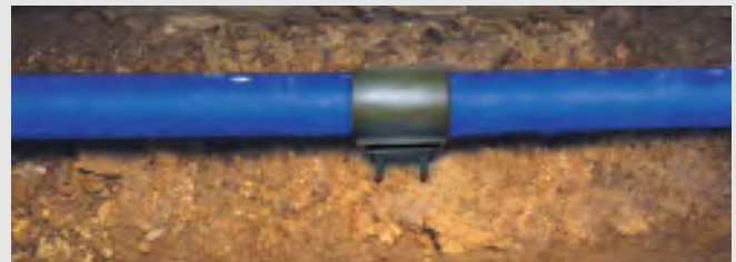
Perbaiki keretakan yang mudah dan cepat sangat penting untuk meminimalkan gangguan bagi konsumen. Terlihat Repair Clamps AVK dipasang.
