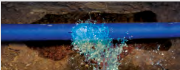
Retak longitudinal khas pada pipa yang biasanya disebabkan oleh penurunan tanah atau peningkatan beban lalu lintas.
